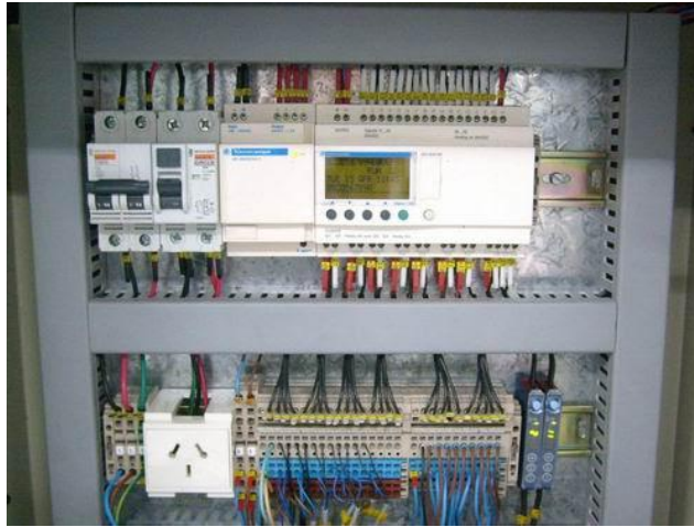
Figura 7 Tablero Electrico con PLC incorporado. Fuente: Guillermo E.BECKER (s.f).
