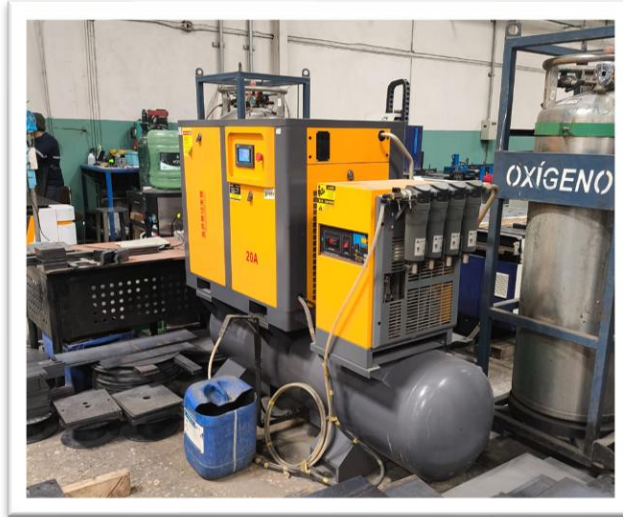
Figura 27 Compresor puesto en Fabrica.
