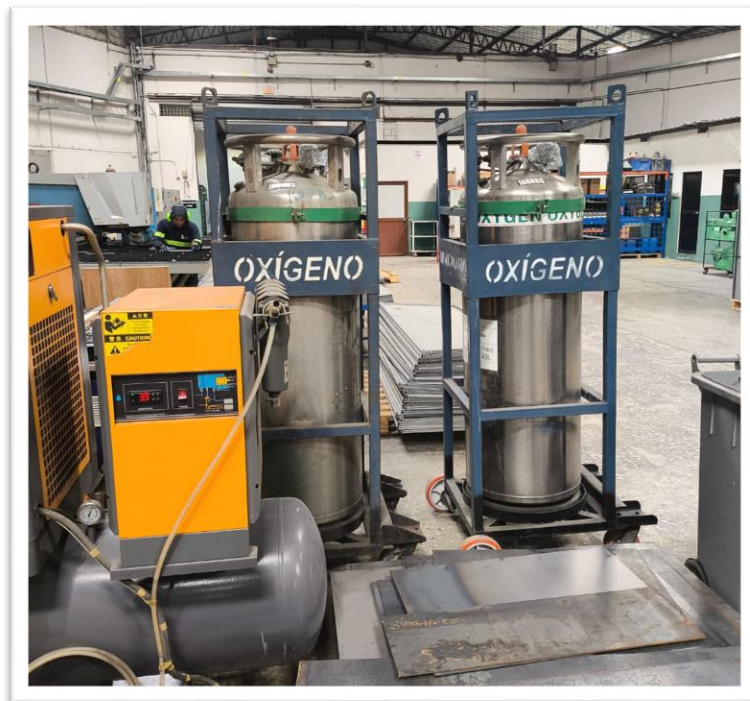
Figura 26 Tanques de oxígeno y aire comprimido puestos en Fabrica.
