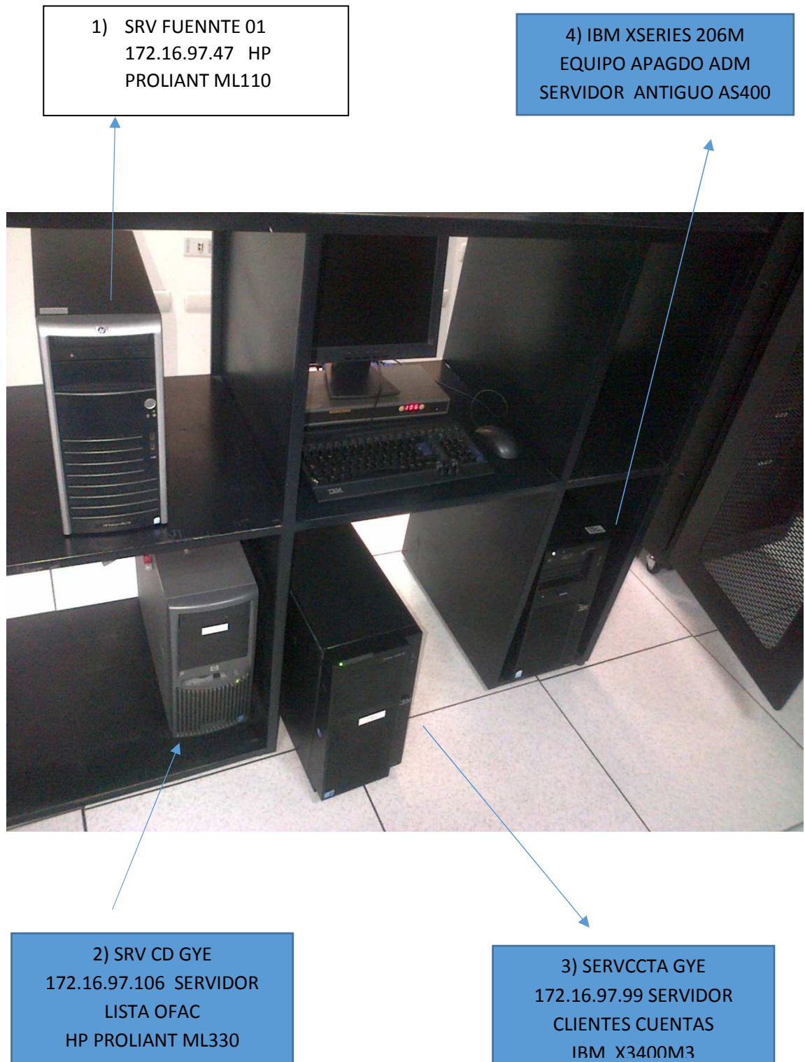
Fig. 7 Servidores Repisa del centro de Computo Alterno
