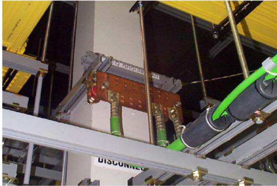
Barra cobre perforada para la conexión a tierra de los diferentes racks y equipos. www.panduit.com
