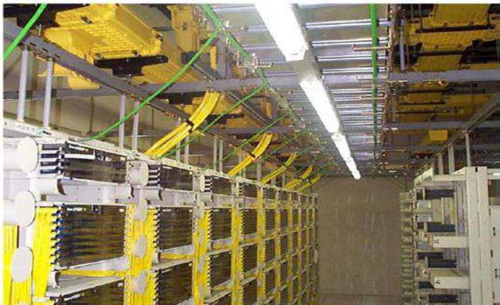
Conexiones a tierra de racks dentro de un cuarto de telecomunicaciones.
