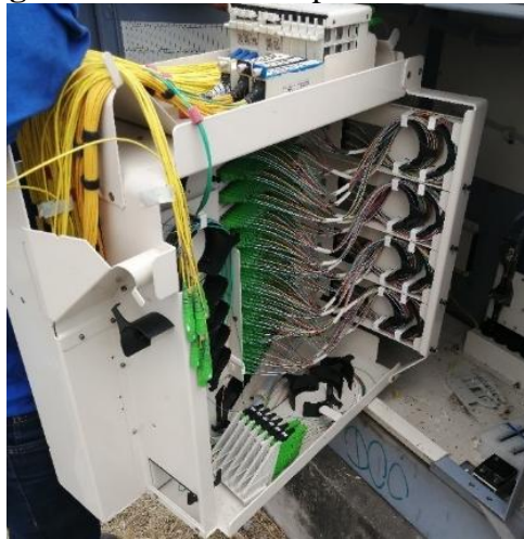
Figura 2.14: Armario óptico vista interna
