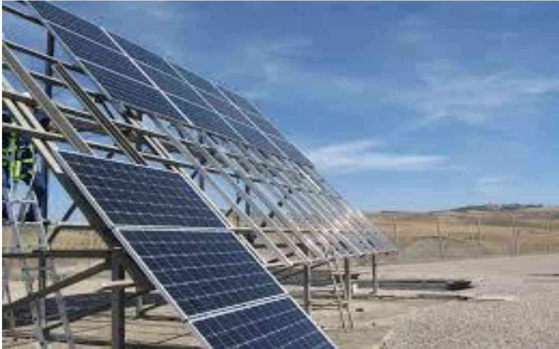
Figura 15. Estructura para panel solar
