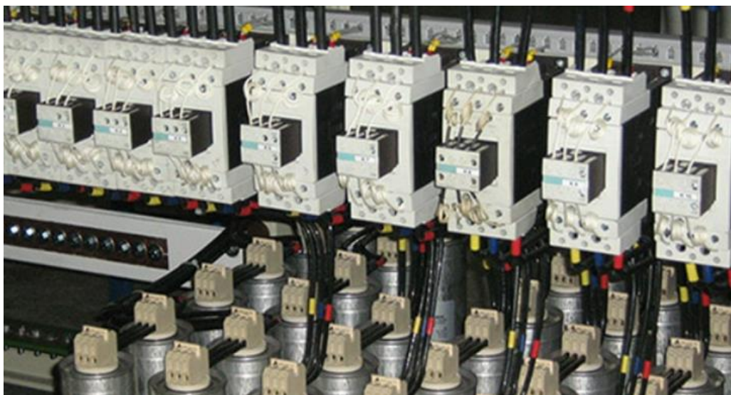
Figura 1. Banco de capacitores
