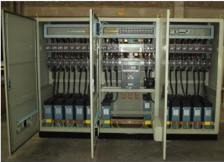
Figura 9. Banco de capacitores automatizado
