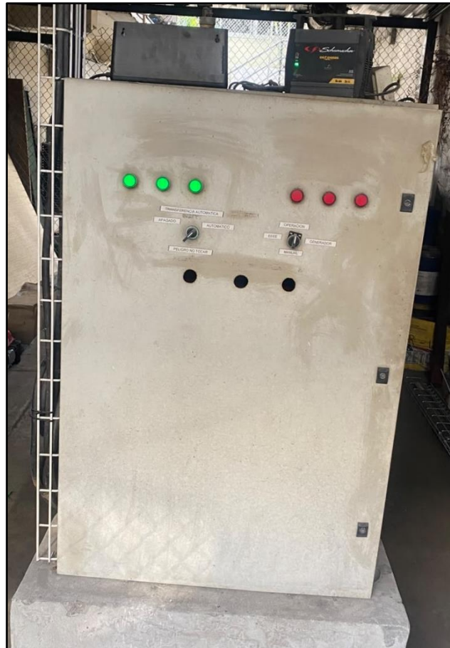
Figura 3. 4:Tablero de control de centro de cómputo (UCSG).
