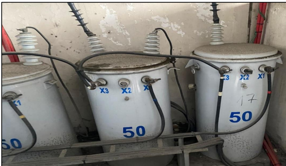
Figura 3. 2: Banco de transformadores de 50 kVA.
