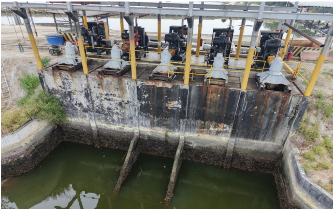
Figura 8. Vista frontal del sistema de captación y disposición de bombas axiales verticales
