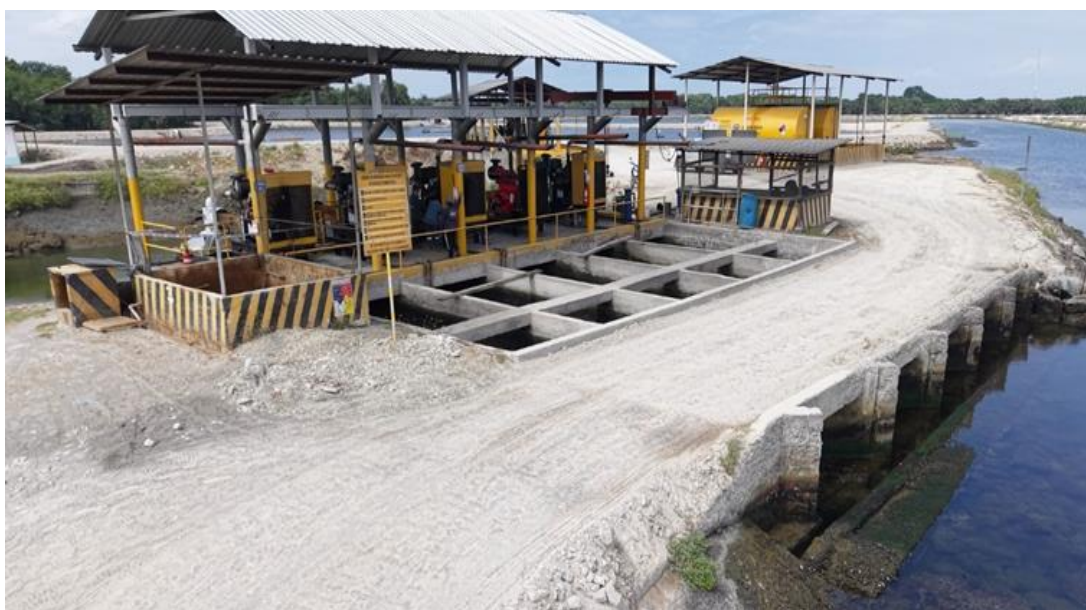
Figura 7. Vista general de la estación principal de bombeo y su integración con el canal de captación
