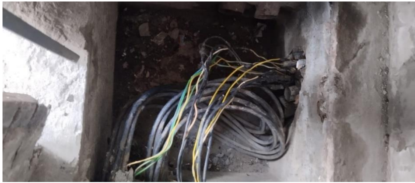
b. Pozo de revisión existente sin protecciones.
