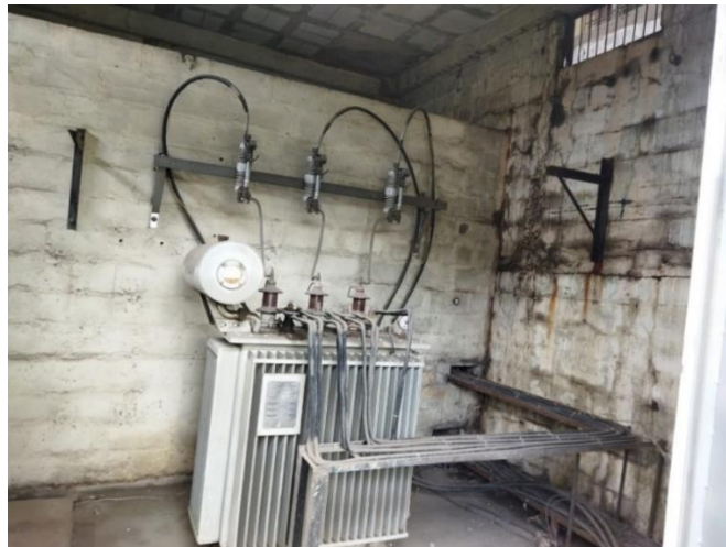
Figura 31 Transformador trifásico de 200 KVA de distribución con medición indirecta para edificio principal
