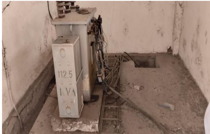
Figura 30 Transformador trifásico de 112.5 KVA de distribución con medición indirecta para diferentes áreas.
