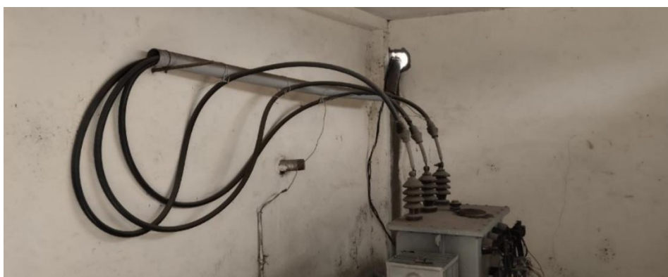
Figura 29 Transmisión subterránea existente
