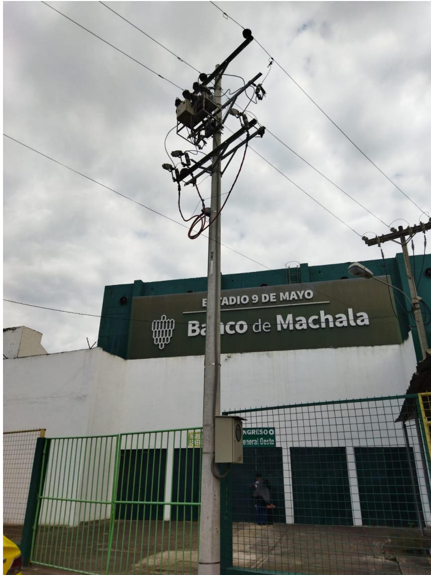
Figura 27 Reconector manual existente
