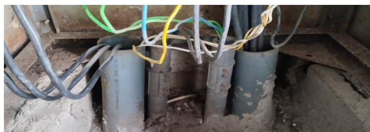
Figura 36 Instalaciones eléctricas existentes
