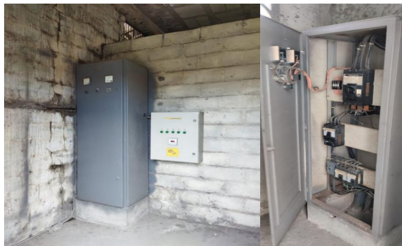
Figura 33 Tablero de distribución principal
