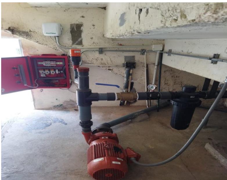
Figura 37 Cuarto de bombas
