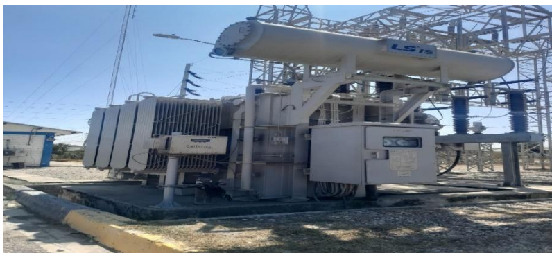
Figura 5 Transformador de la subestación Playas
