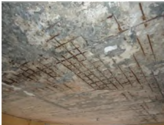
Figura 1.6 Corrosión en losa
