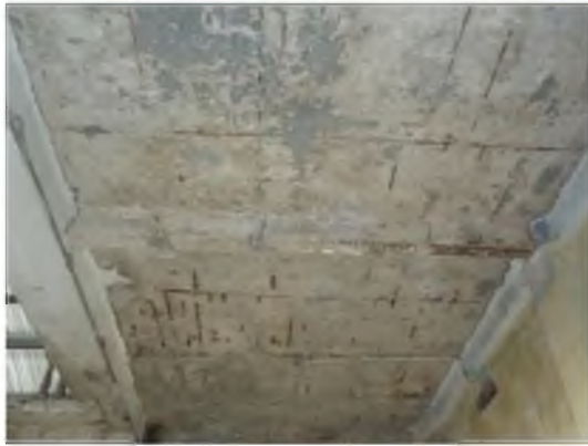
Figura 1.4 Corrosión en losa
