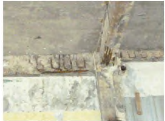
Figura 1.5 Corrosión en vigas
