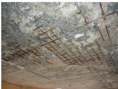
Figura 1.5 Corrosión en losa
