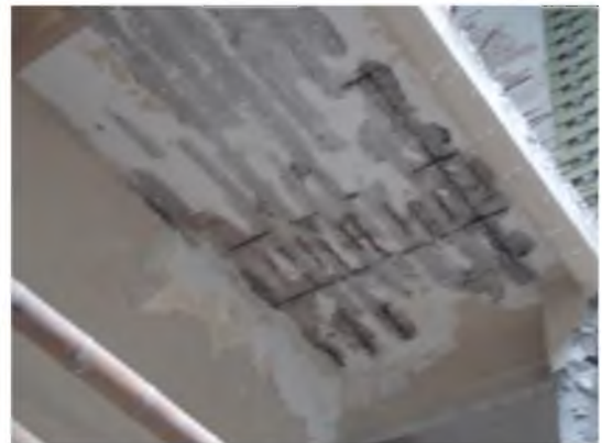
Figura 1.7 Corrosión en losa
