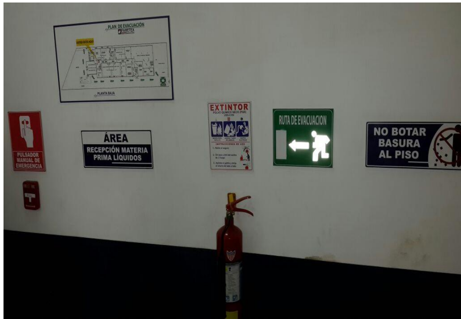
Gráfico 13: Área de extintores y señalización Fuente: FAVETEX
