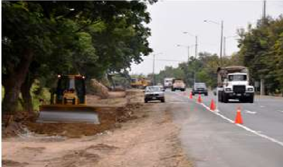
Foto 5: Vía de acceso en construcción sector Holcim (Autor: Juan Ignacio de la Fuente)
