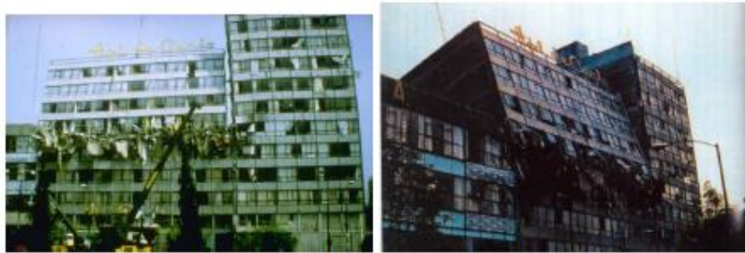
Figura 90 Falla debido al Golpeteo de Edificios
