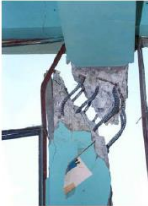
Figura 75 Colapso de Columna por Ausencia de Estribos
