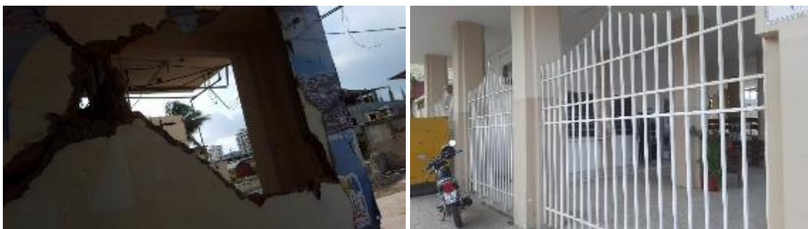
Figura 139 Fallas en Mampostería Planta Baja, por Piso blando – Edificio Municipal
