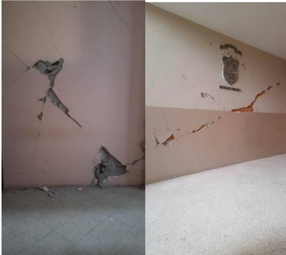
Figura 138 Fallas por mala Instalación de Tuberías – Edificio Municipal
