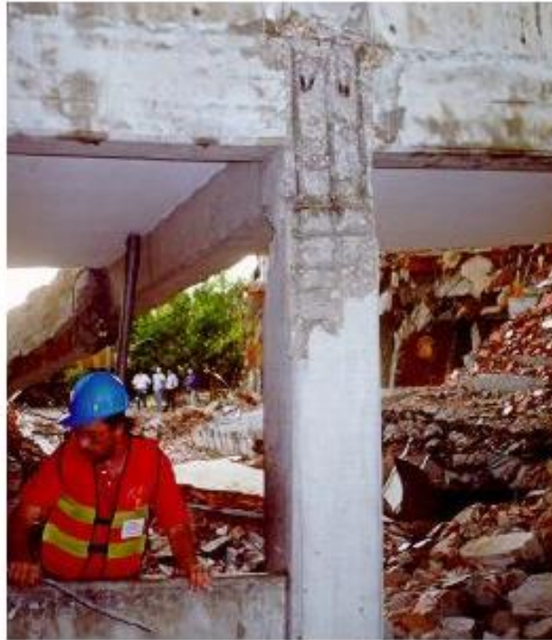
Figura 80 Ausencia de Etribos en Junta Viga-Columna
