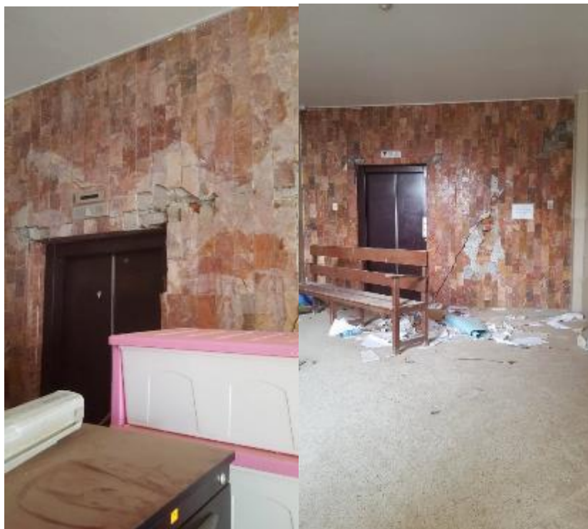
Figura 137 Fallas en zonas de Ascensores – Edificio Municipal
