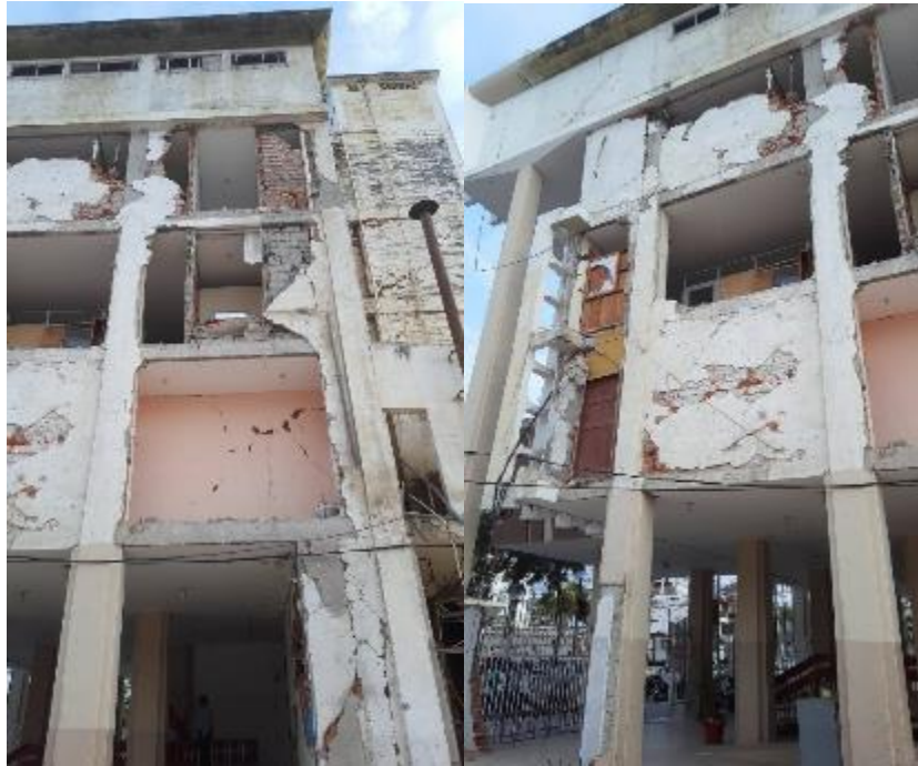
Figura 135 Fallas en Mampostería fachada lateral derecha – Edificio Municipal
