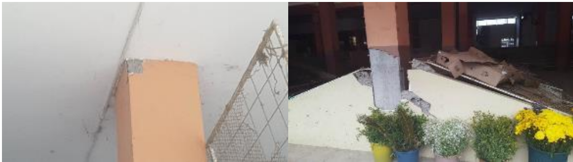
Figura 147 Fallas en columnas – Mercado Municipal
