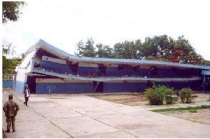
Figura 78 Daño Causado por falta de Rigidez lateral, Sismo de Cariaco, 1997.
