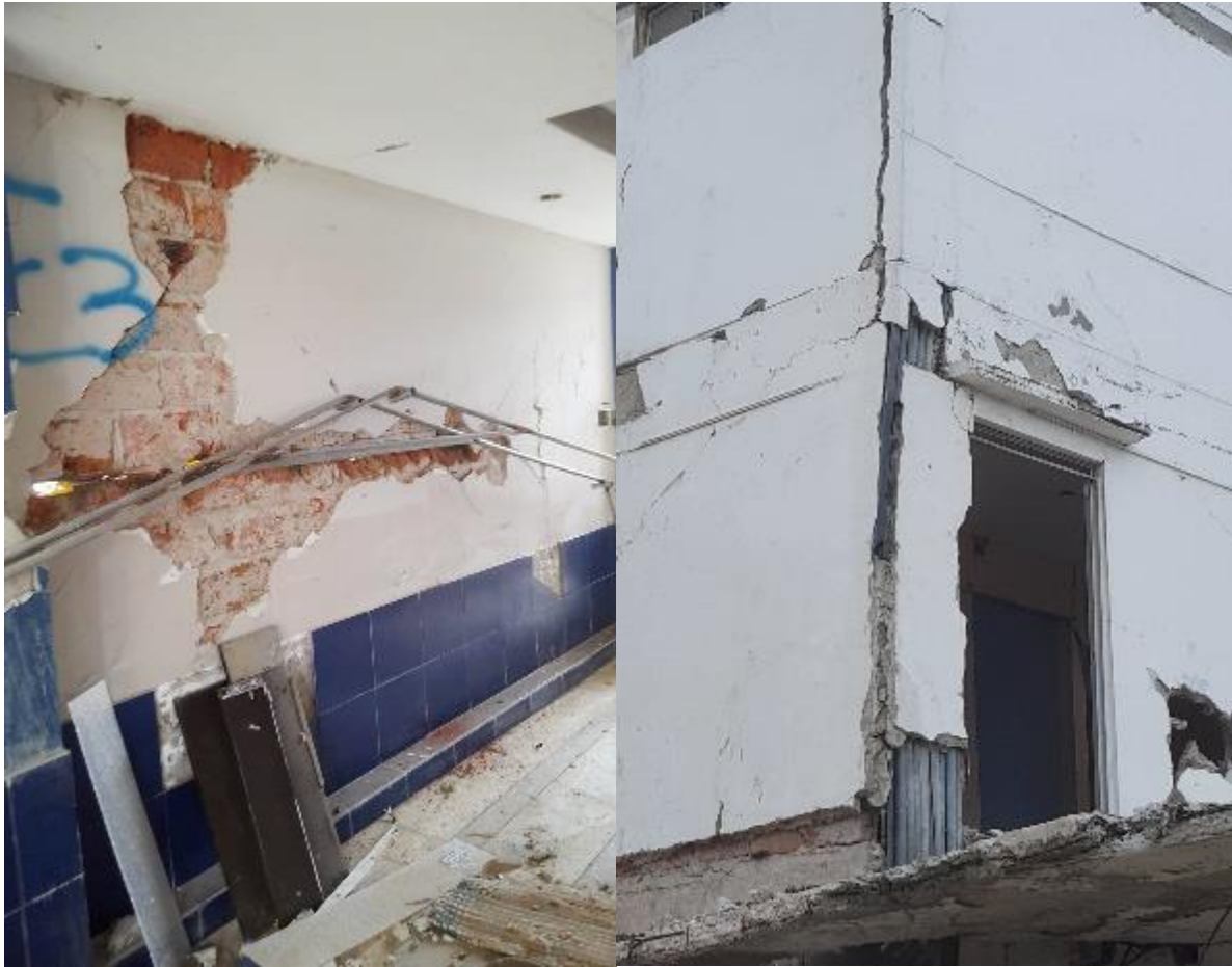
Figura 124 Incorrecta instalación de Tuberías en la Mampostería – Edificio Jalil
