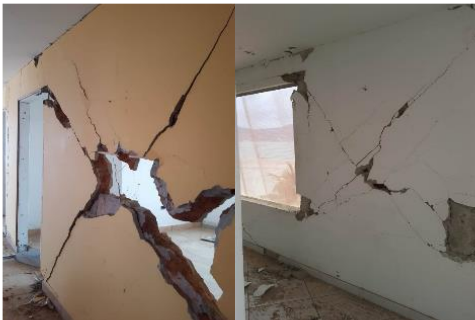
Figura 121 Fallas Diagonales en Mampostería – Edificio Jalil
