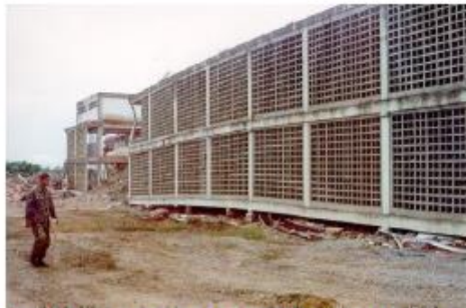
Colapso total de la planta baja del edificio. Liceo Raimundo Martínez, Cariaco, 1997.
