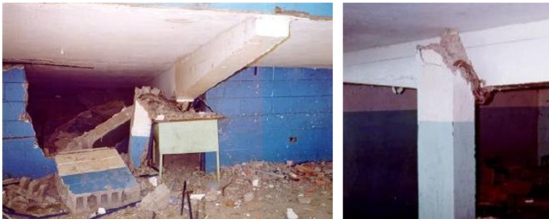
Figura 79 Sismo de Cariaco, 1997. Fallas en Nudos
