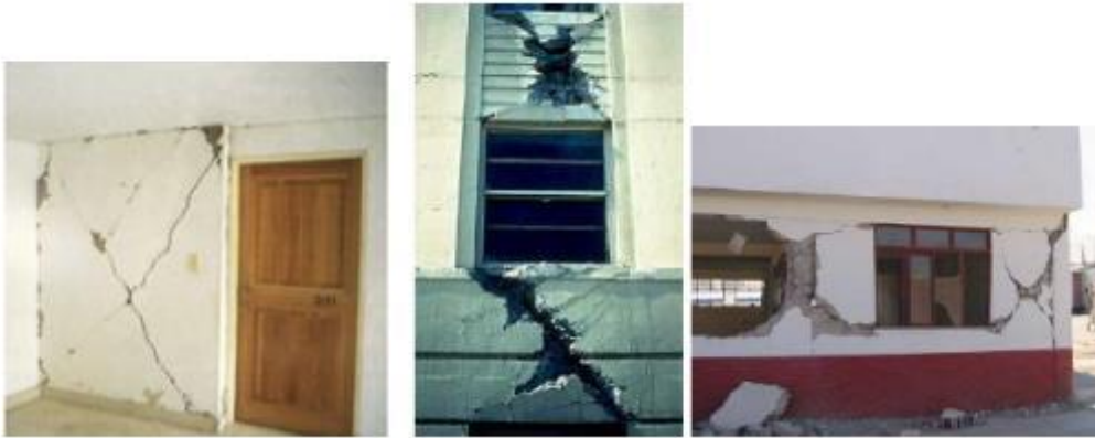
Figura 84 Falla en Forma de “X” en Muros de Cortante.
