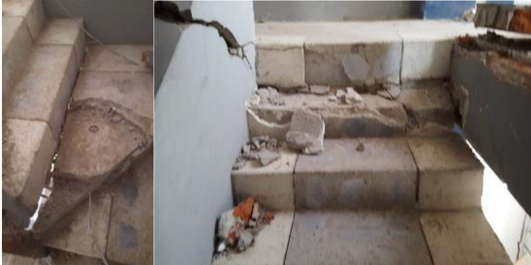
Figura 133 Rotura bloque de escalera parte inferior – Edificio Jalil
