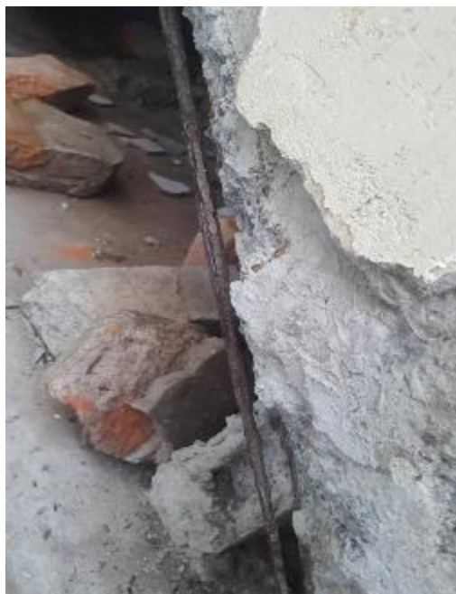
Figura 148 Fallas en Escaleras – Mercado Municipal
