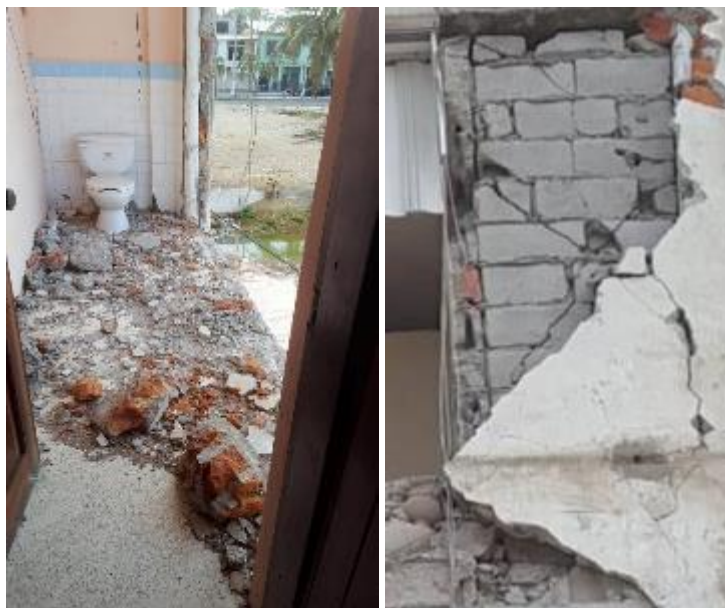
Figura 136 Falta de Confinamiento en Mamposterías – Edificio Municipal
