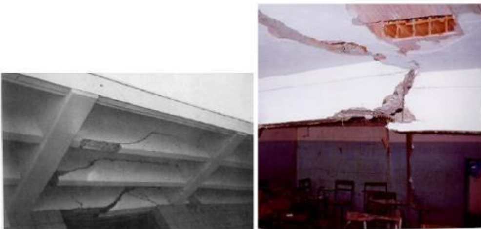
Figura 76 Fallas en Vigas por Tensión Diagonal
