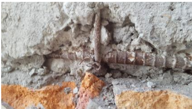
Figura 142 Desprendimiento de recubrimiento en Vigas – Edificio Municipal
