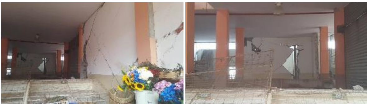
Figura 145 Fallas en Mampostería Estructura del Mercado
