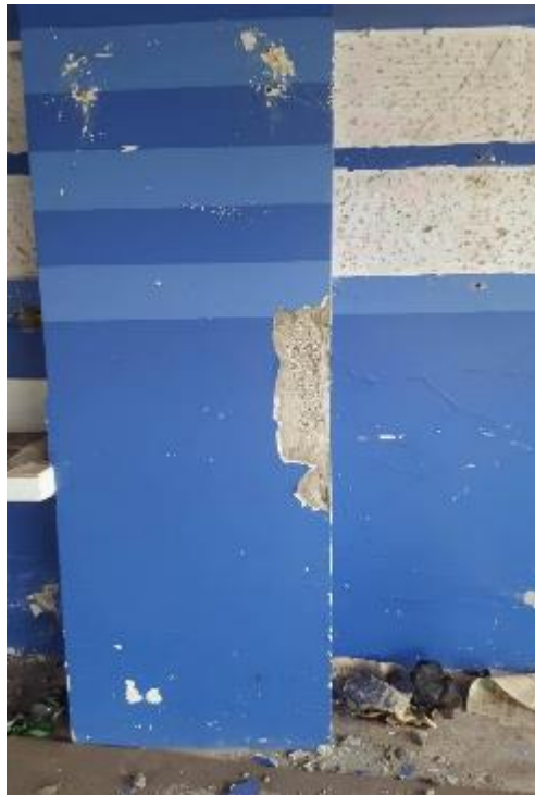
Figura 127 Desprendimientos del recubrimiento en columnas desde Planta alta hasta el último piso – Edificio Jalil
