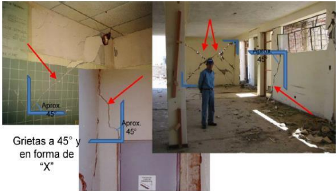
Figura 73 Típica grieta originada en tabiquerías por eventos Sísmicos
