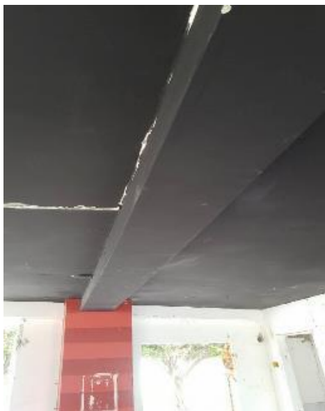
Figura 131 Deflexiones Permanentes en losas y vigas – Edificio Jalil
