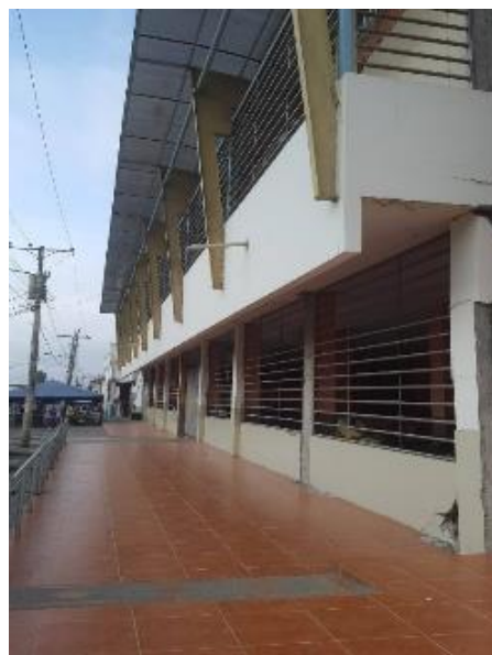
Figura 144 Fallas en Estructura Mercado Municipal
