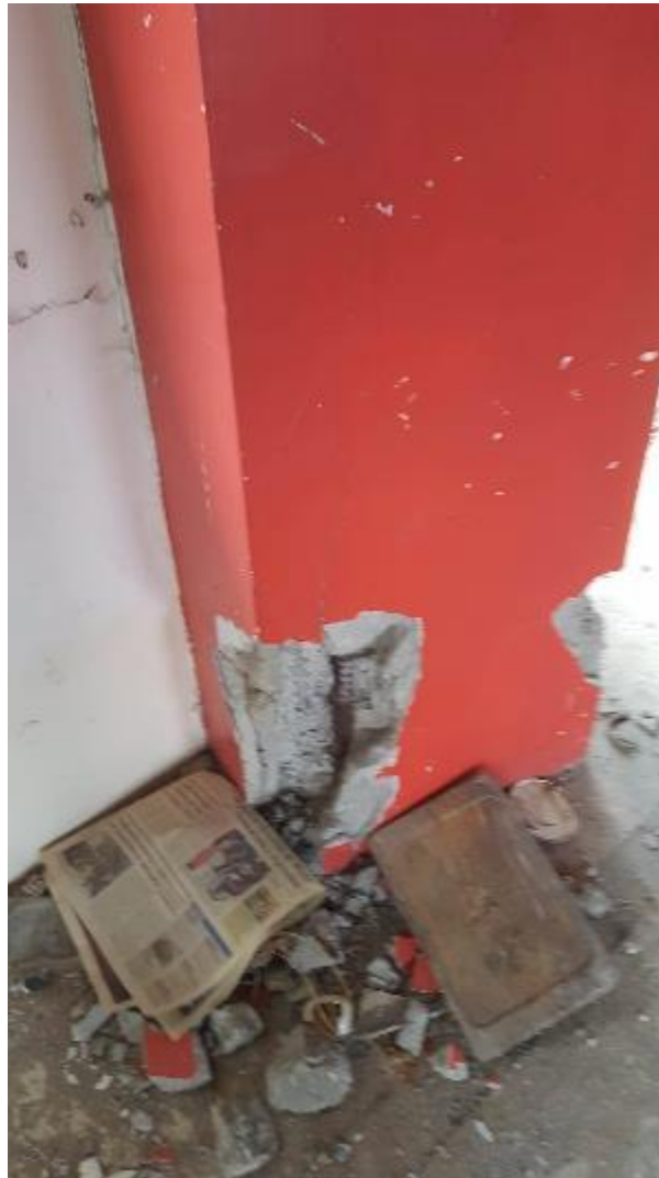
Figura 126 Oxidación de varillas de Refuerzo Columnas Planta Baja – Edificio Jalil
