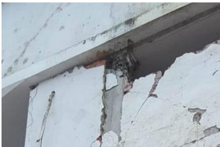
Figura 141 Despostillamiento Columna de Lindero derecho – Tercer Piso Alto – Edificio Municipal
