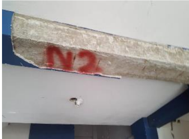
Figura 130 Exposición de varillas de refuerzo en vigas por falta de Recubrimiento – Edificio Jalil
