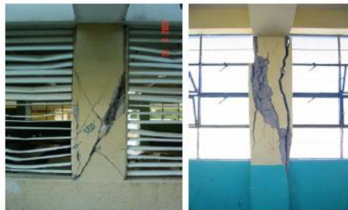
Falla típica de columna corta.
