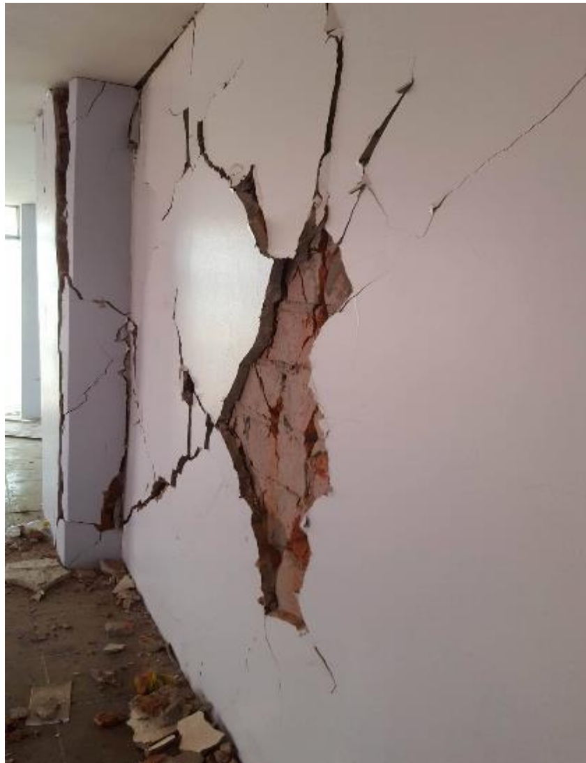
Figura 122 Recubrimientos Excesivos en Mampostería – Edificio Jalil
