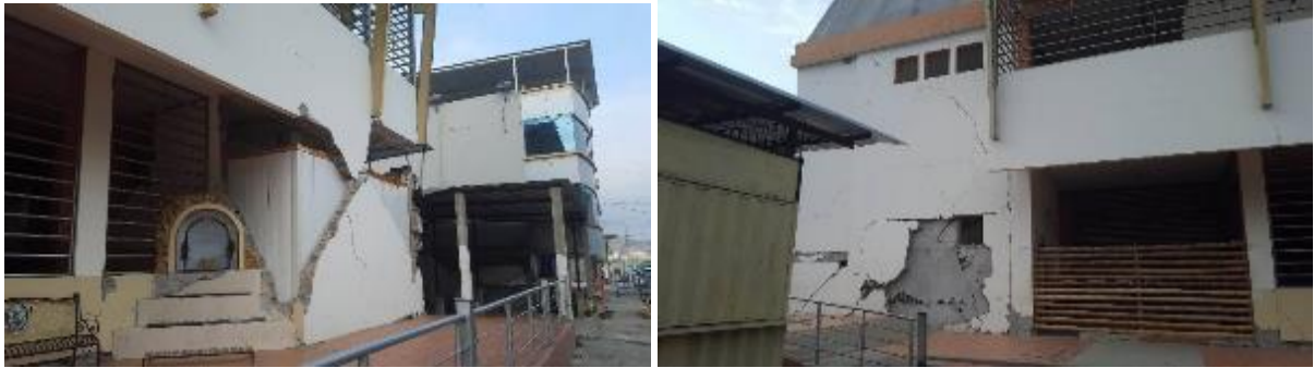
Figura 146 Fallas de mampostería Fachada Principal – Mercado Municipal
