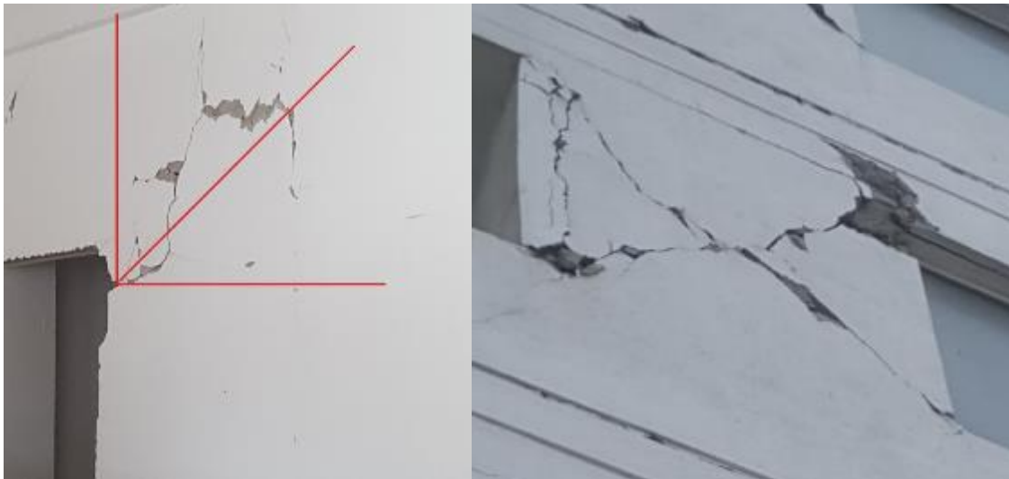
Figura 72 Grietas por tensión diagonal Edificio La Fragata
