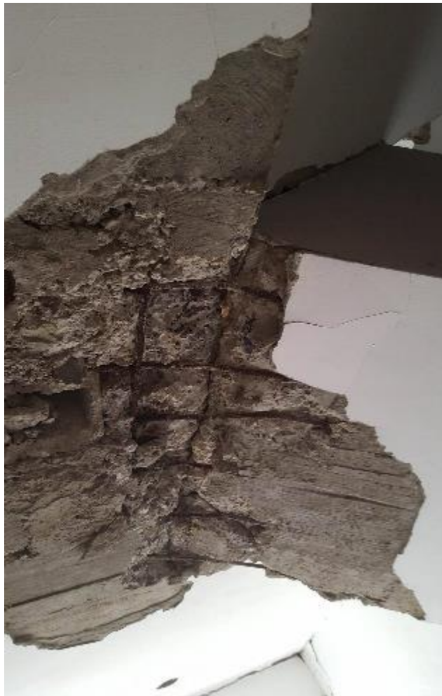
Figura 132 Rotura bloque de escalera parte inferior – Edificio Jalil
