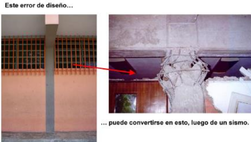
Falla típica de columna corta (Ambas fotos son de instituciones educativas venezolanas)
