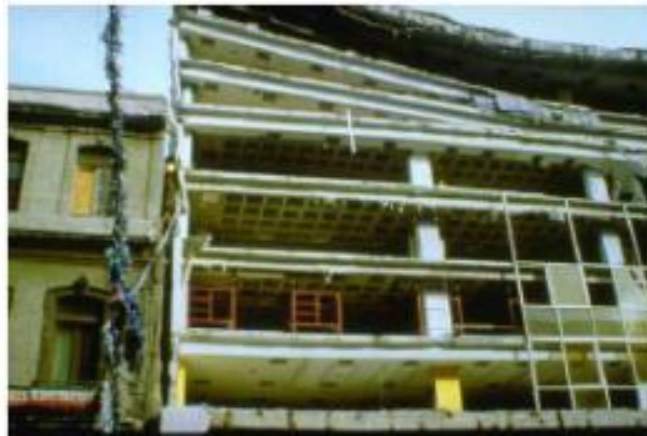
Figura 97 Colapso por Amplificación de Pisos Superiores
