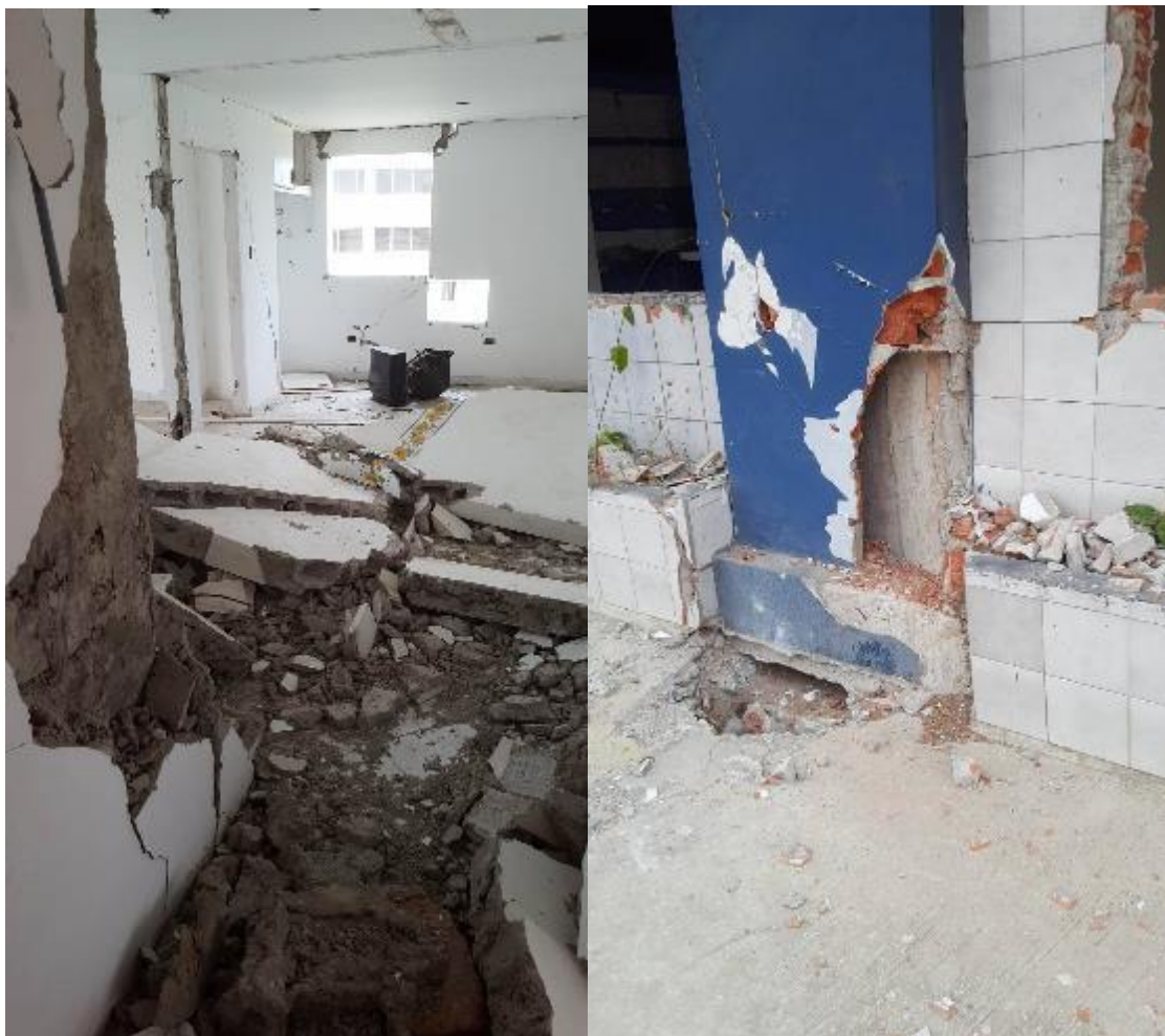
Figura 123 Mampostería mal Confinada – Edificio Jalil
