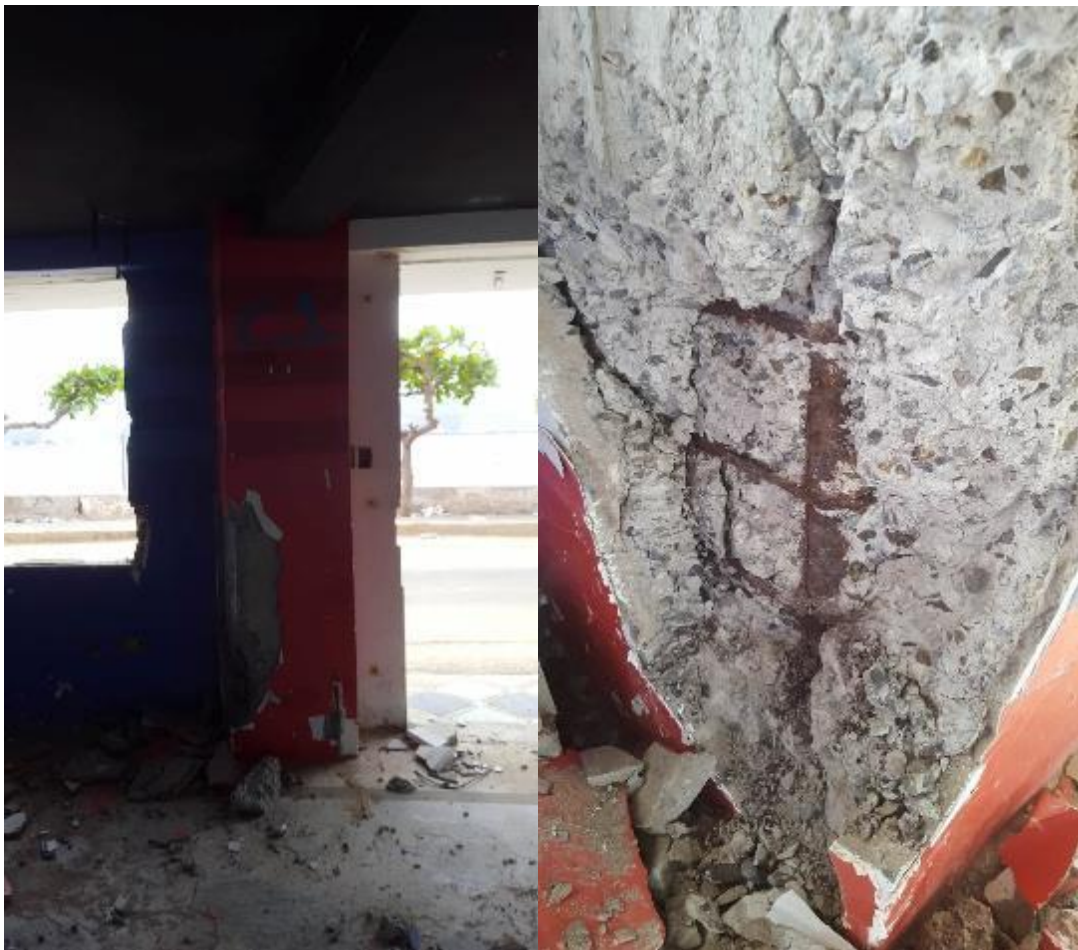
Figura 125 Desprendimientos y Agrietamiento del Hormigón en Columnas Planta Baja – Edificio Jalil
