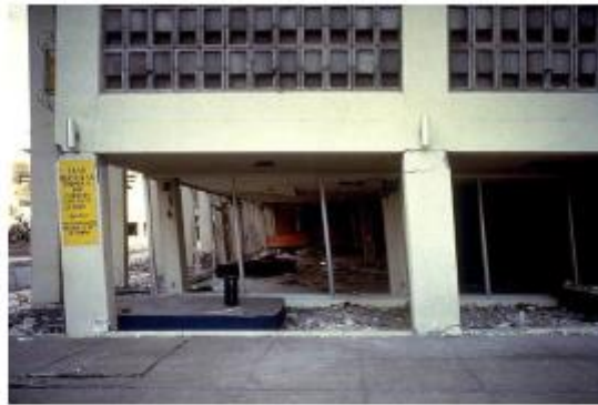
El daño estructural provocado por la planta débil, conllevó a la inutilización del edificio.
