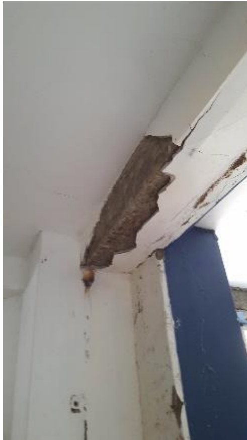
Figura 129 Desprendimientos del Enlucido en Vigas – Edificio Jalil
