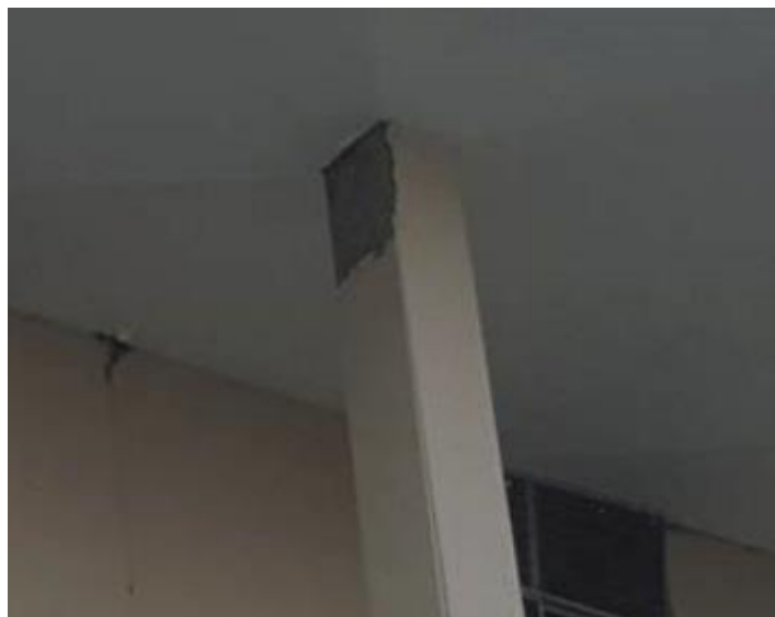
Figura 140 Pequeñas fallas al comienzo de Columna – Planta Baja – Edificio Municipal.
