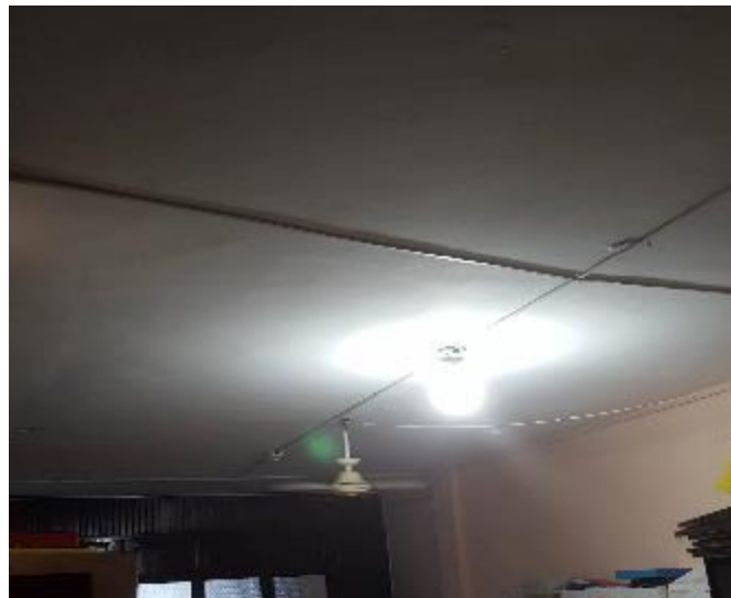
Figura 143 Deflexión en losa del segundo piso – Edificio Municipal
