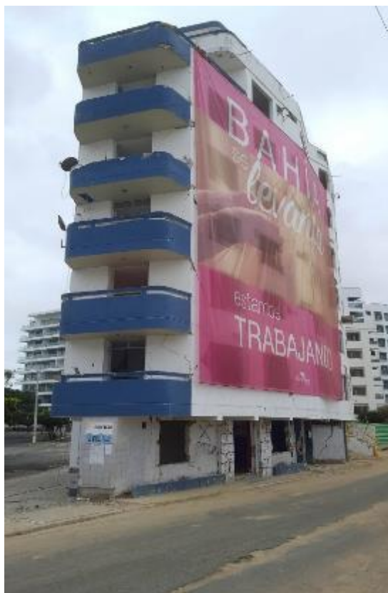
Figura 120 Fallas del Edificio Jalil
