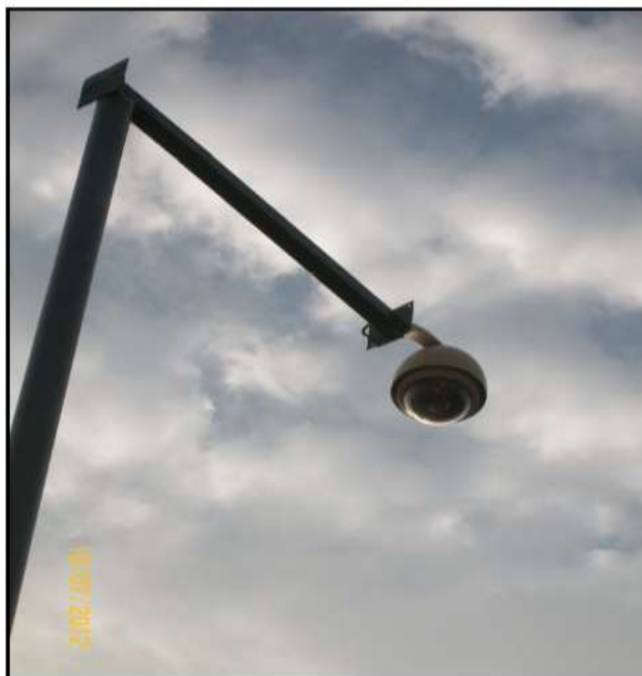
Grafico 4.8 Implementación Fase 1: Vista Inferior de Cámara PTZ
