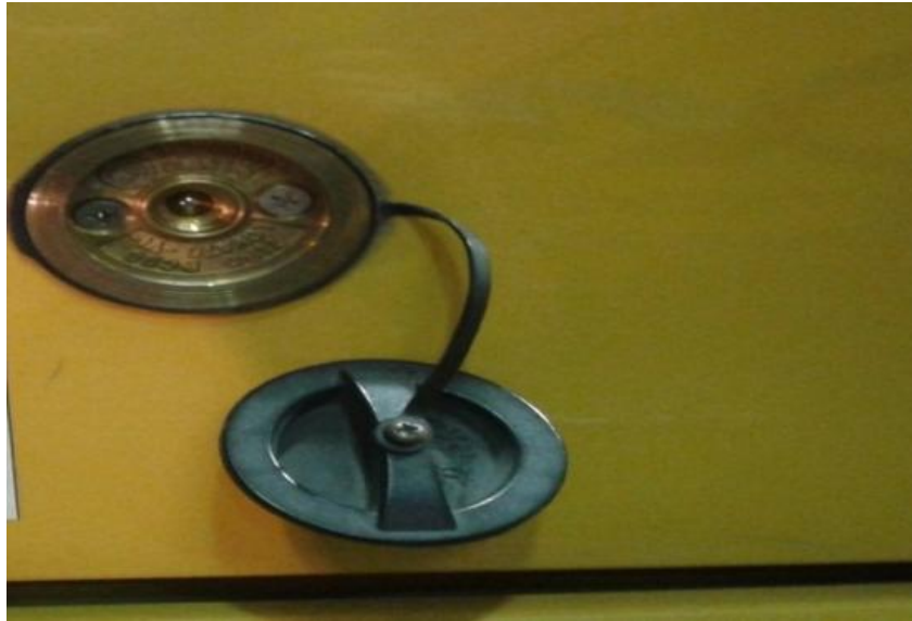
VÁLVULA DEL VEHÍCULO DE ENTRADA DE GAS.
