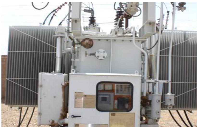
Figura 2. 24 Transformador de potencia
