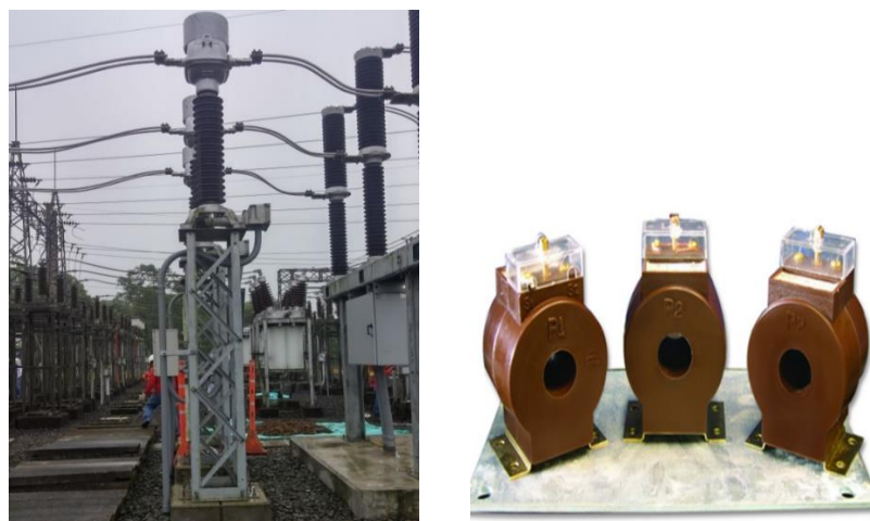
Figura 2. 12 Transformador de corriente
