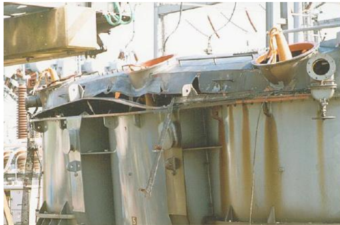
Figura 2. 35. Transformador luego de una falla interna
