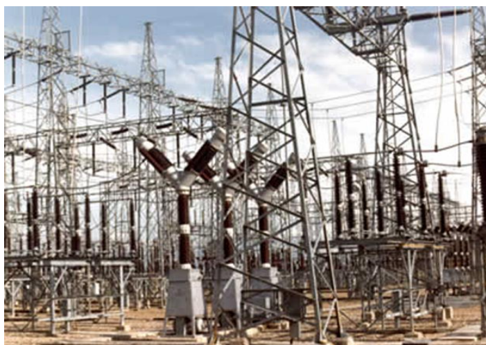
Figura 2. 1 Subestación de maniobra
