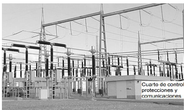
Figura 2. 5 Subestación eléctrica tipo intemperie
