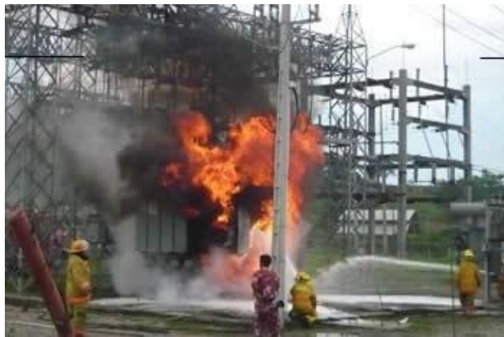
Figura 2. 31. Incendio en un transformador de potencia
