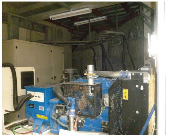
Figura # 40 Generador Edificio Medicina Fuente: Autor
