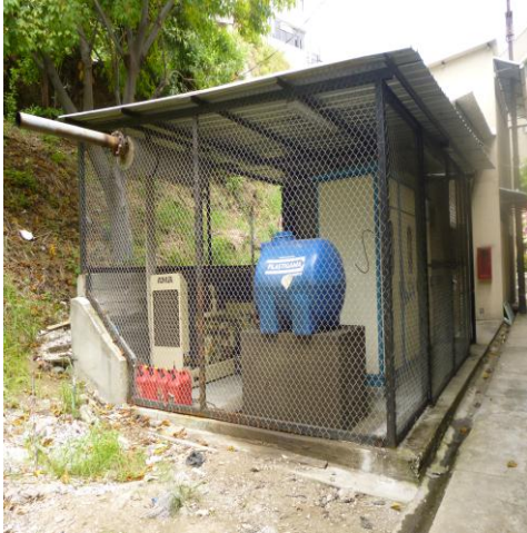
Figura # 43 Generador Edificio Principal
