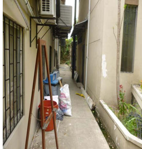
Figura # 44 Entrada Generador Edificio Principal
