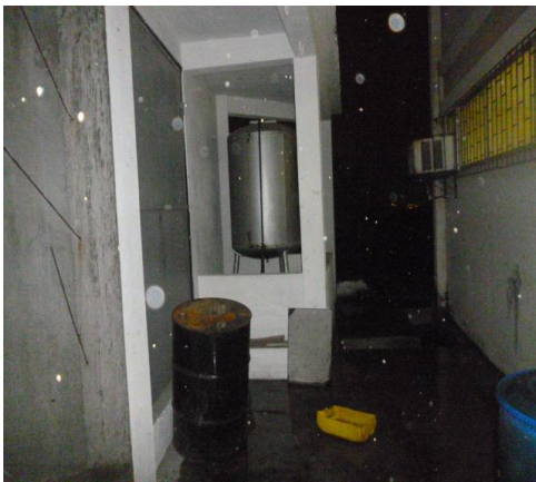
Figura # 36 Foto Nocturna del exterior del cuarto del generador Fuente: Autor
