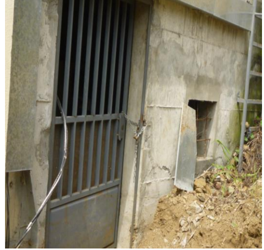
Figura # 39 Generador Edificio Medicina Fuente: Autor
