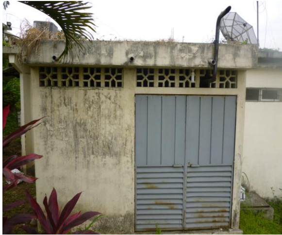
Figura # 48 Cuarto de Generador F. Técnica Fuente: Autor
