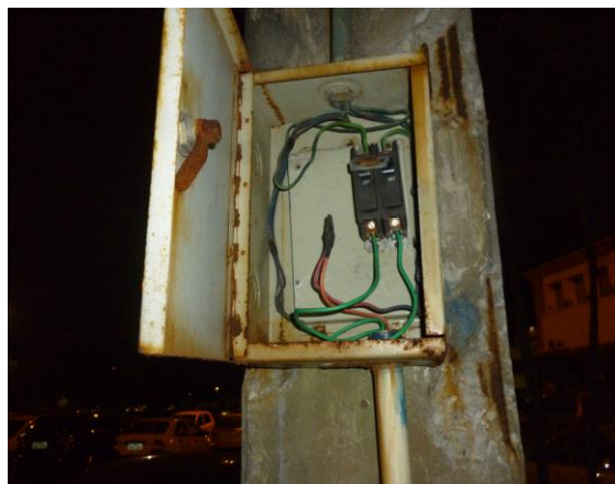
Figura # 51 Cajas de Breaker Torre de Iluminación Cód. 16I 8 Fuente: Autor
